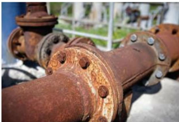
La oxidación del hierro conduce a la corrosión y/o la formación de una capa escamosa, adquiriendo así la tonalidad que variaría desde amarillos u ocres, pasando por diferentes tonalidades rojas, marrones y anaranjadas según fuese la pureza del mineral, hasta tonalidades marrones muy oscuras
